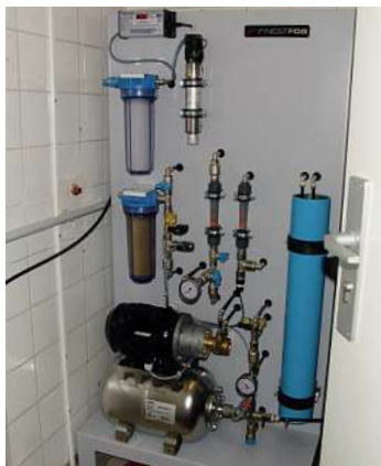
Die Reinwasseranlage arbeitet nach dem Prinzip der Umkehrosmose und entfernt alle Feststoffe.
