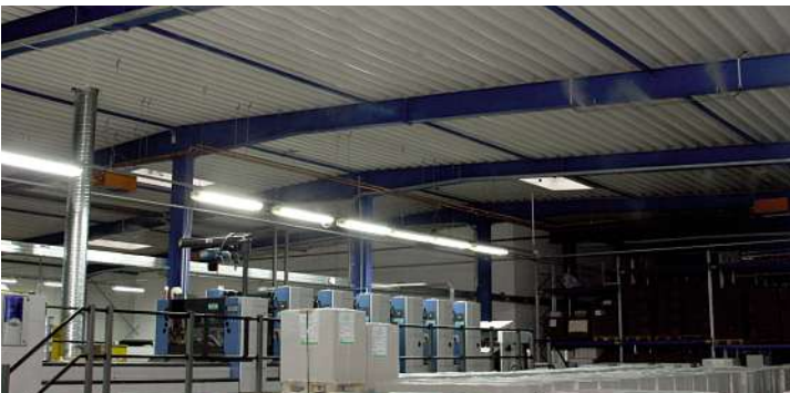
Mit der neuen Befeuchtungsanlage von Finestfog hält noble-pac die relative Luftfeuchte beständig auf 55% und sorgt für gleichbleibendes Klima.
