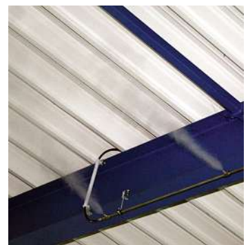
Die Hochdruckbefeuchtung sprüht Wassernebel in den Drucksaal.
