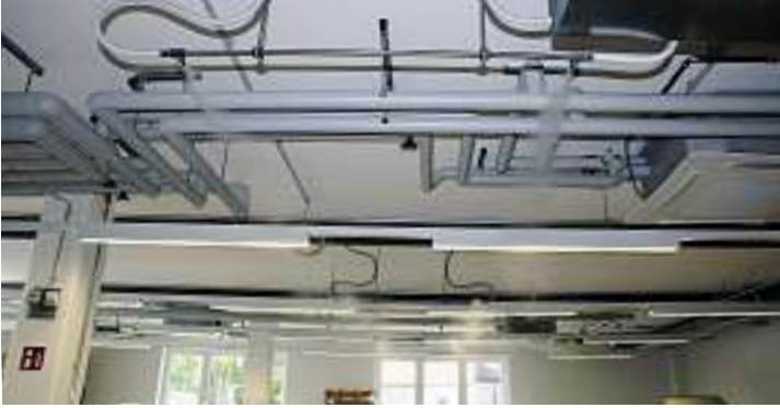
44 Finestfog-Hochdruckdüsen im Pinsker-Betriebsgebäude und 22 im neuen Erweiterungsbau sorgen für eine optimale Luftfeuchtigkeit von 50 Prozent.
