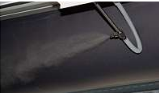
Bis zu 106 Liter bzw. 34 Liter Wasser können in den beiden Gebäuden pro Stunde versprüht werden.
