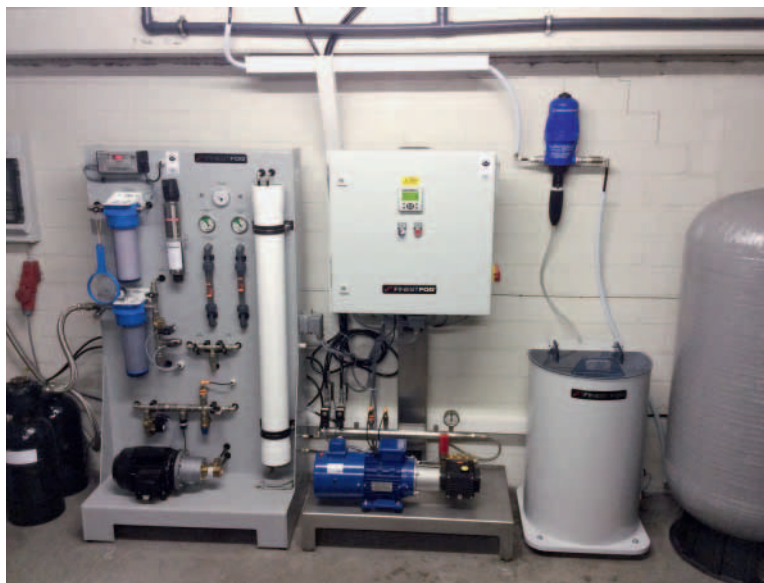
Wasseraufbereitung – Enthärtungsanlage, Umkehrosmoseanlage, Luftbefeuchtung und kontrollierte Rückaufhärtung durch Dosiereinheit.
