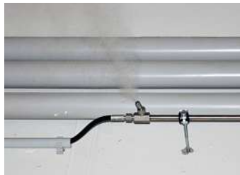
16 Hochdruckdüsen unter der Decke befeuchten den 750 m 2 großen Saal mit bis zu 52 l Wasser pro Stunde.
