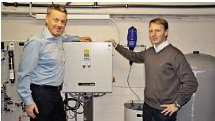
Finestfog-Geschäftsführer Christian Wagner (l.) und Weppert-Betriebsleiter Christian Deppert an der Wasseraufbereitungsanlage von Finestfog.
