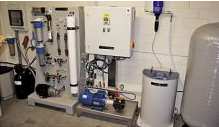
Finestfog im Überblick: Reinwasseranlaseanlage mit Osmosemodul, die Hochdruck-Luftbefeuchtung und die Wiederaubereitungsanlage – jetzt inklusive Puffertank – zur Aufhärtung des Wassers für die Druckmaschinen.
