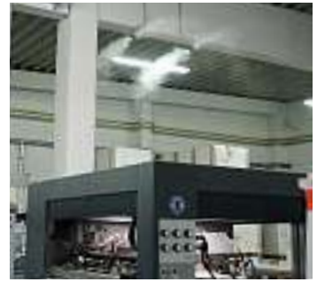
28 Finestfog Hochdruckdüsen zerstäuben bei Weppert das Wasser direkt und benötigen somit keine Druckluft oder extra Ventilatoren.
